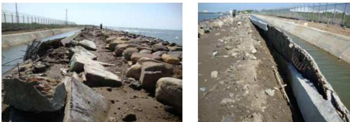
Gambar 2. Kerusakan tembok laut dan saluran air (Sumber : PSIT UGM).
